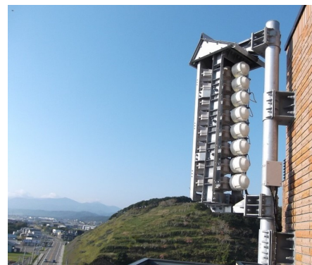
3年の歳月をかけ令和4年度に更新された「防災行政無線」(役場屋上の巨大スピーカー)
