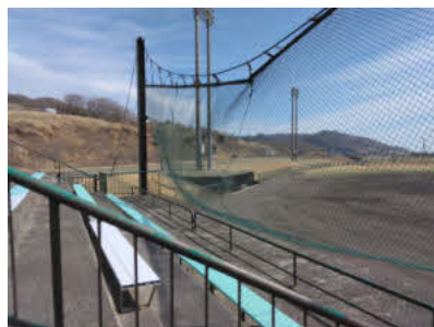
破損し危険な状態のバックネット
