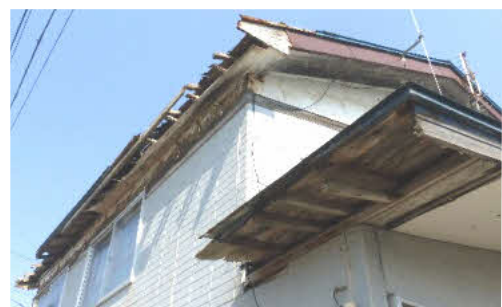
軒の部分が崩れ落ちて いる危険な空き家
